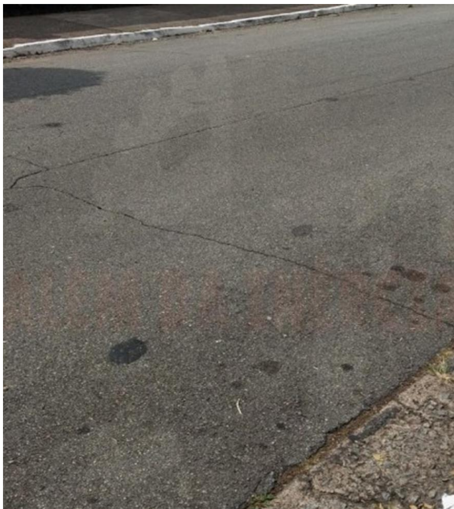
Figura 17 - Trinca Transversal (Transverse Cracking). Fonte: Autor (2018)
