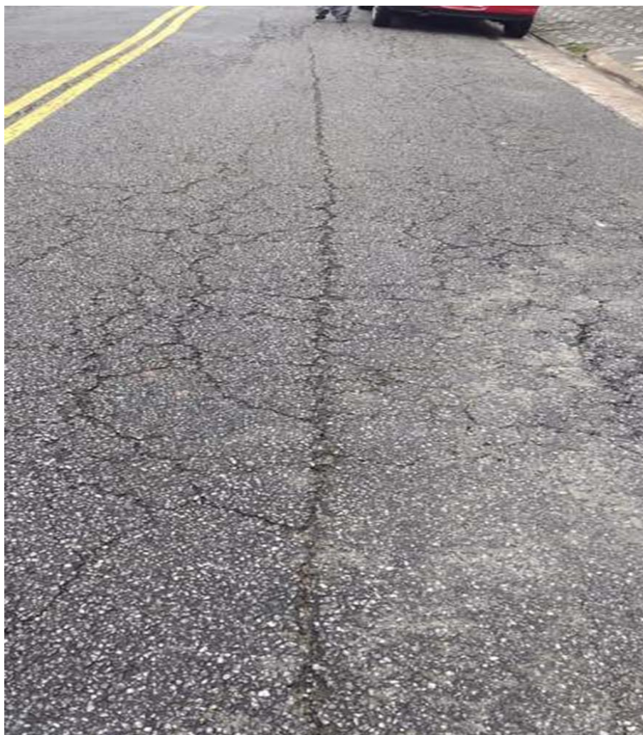
Figura 10 - Trinca Longitudinal (Longitudinal Cracking). Fonte: Autor (2017)
