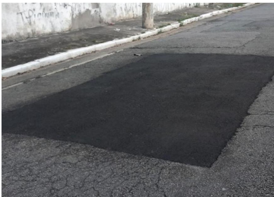
Figura 14 - Remendos (Patch). Fonte: Autor (2018)
