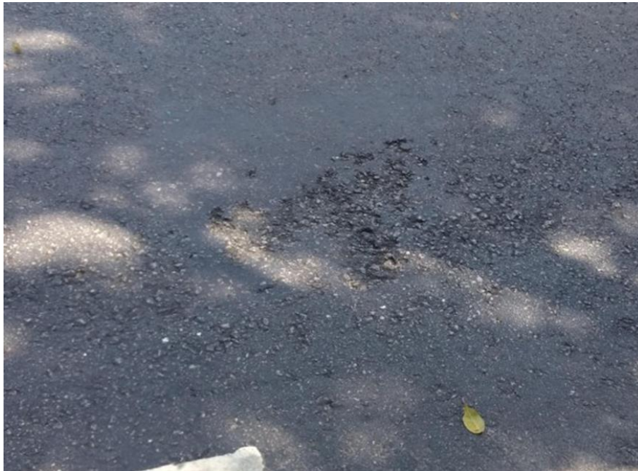
Figura 19 - Exsudação (Bleeding). Fonte: Autor (2018)
