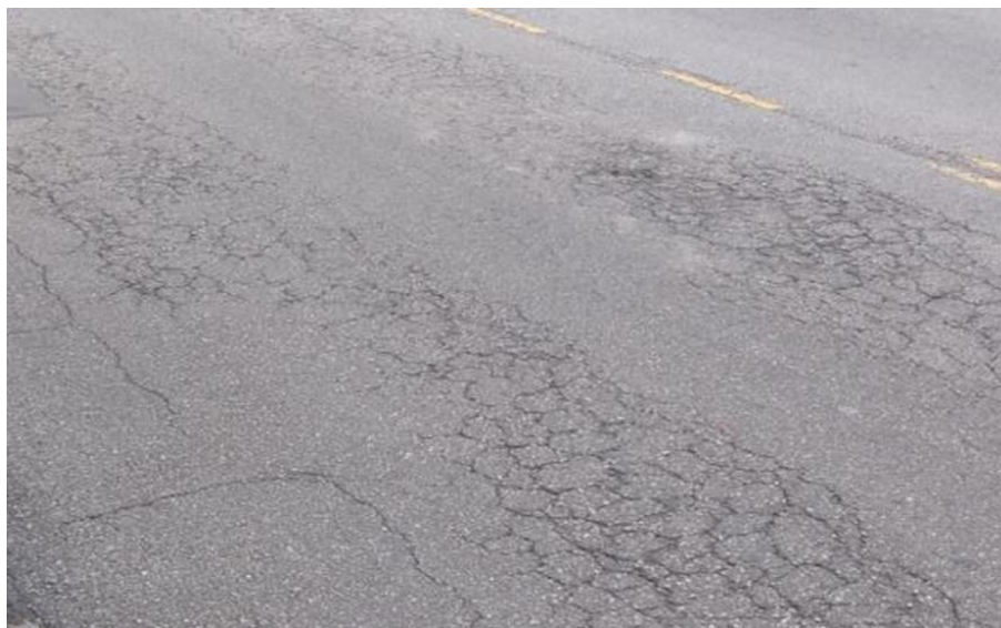
Figura 8 - Deformação Permanente (Rutting) e Trincas de Fadiga (Fatigue Cracking) na trilha de roda. Fonte: Autor (2018)
