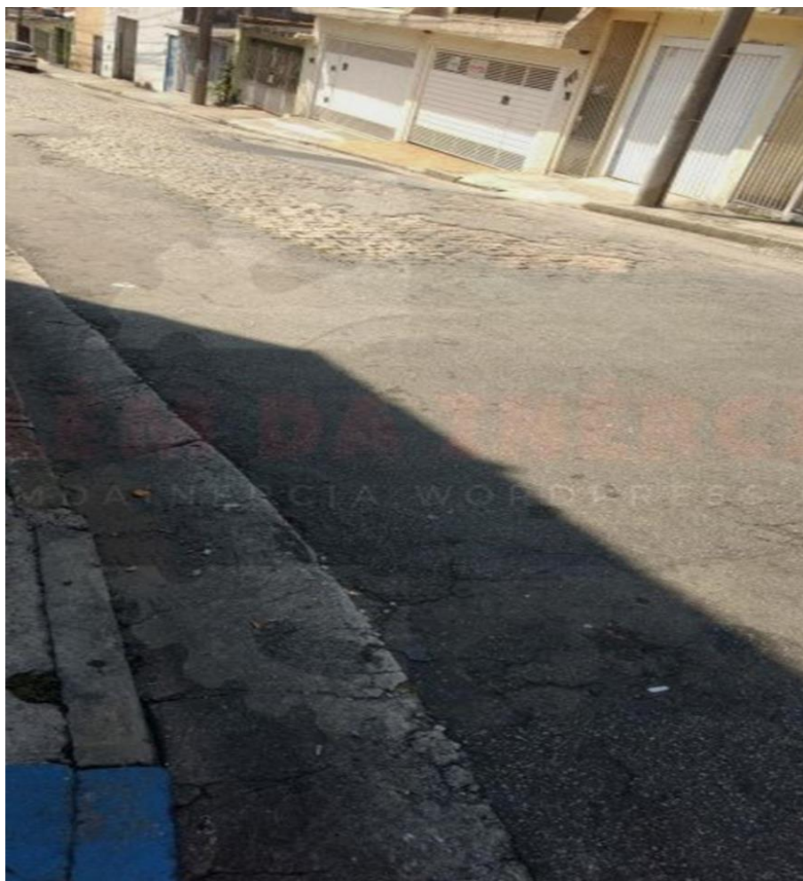
Figura 16 - Falta de Adesividade em Paralelepípedos. Fonte: Autor (2018)
