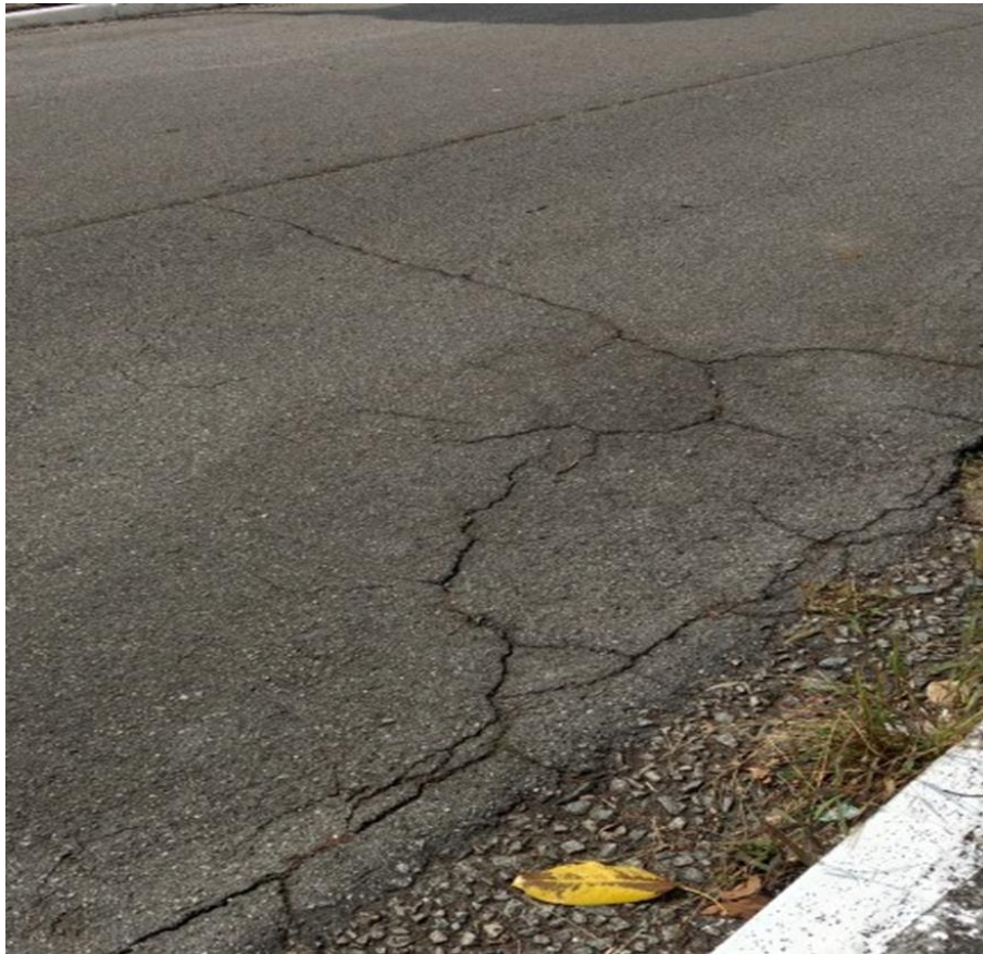
Figura 20 - Trincas de bordo (Edge Cracking). Fonte: Autor (2018)
