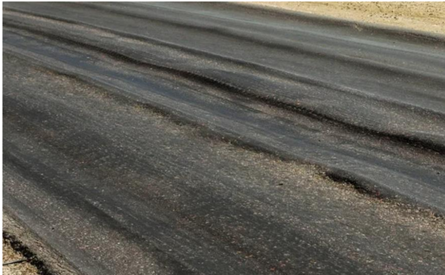
Figura 22 - Deformações ou Ondulações causadas pela passagem de veículos muito pesados e/ou uma má qualidade da base aplicada
