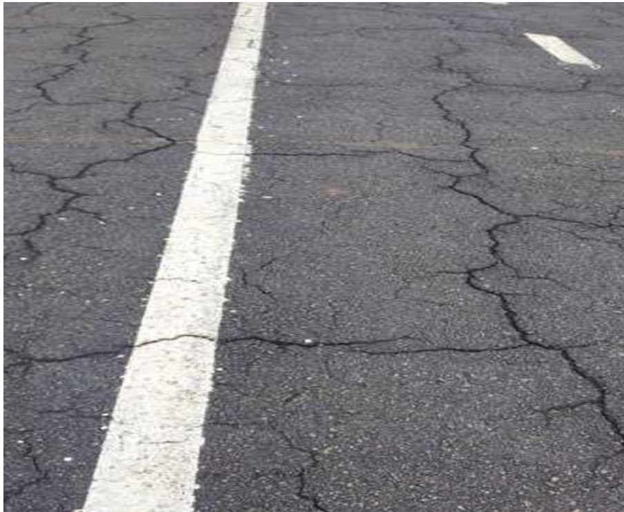
Figura 9 - Trincas de Bloco (block cracking). Fonte: Autor (2018)
