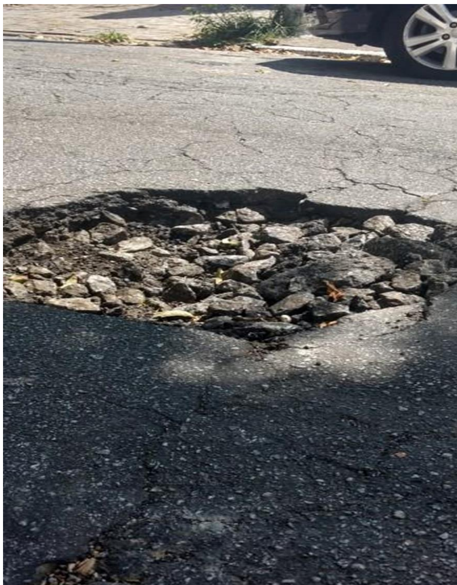
Figura 11 - Panelas (Potholes). Fonte: Autor (2018)
