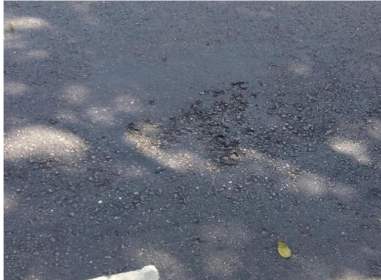
Figura 17 - Exsudação (Bleeding). Fonte: Autor (2018)
