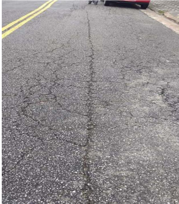
Figura 8 - Trinca Longitudinal (Longitudinal Cracking). Fonte: Autor (2017)
