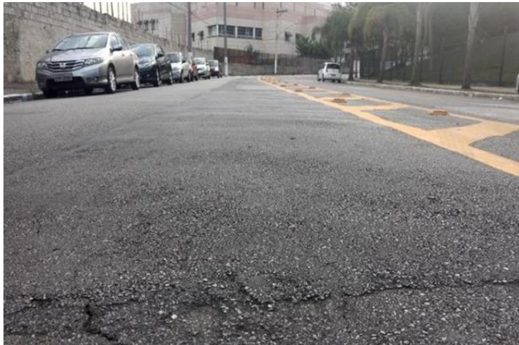
Figura 11 - Corrugações (Shoving and Corrugation). Fonte: Autor (2018)
