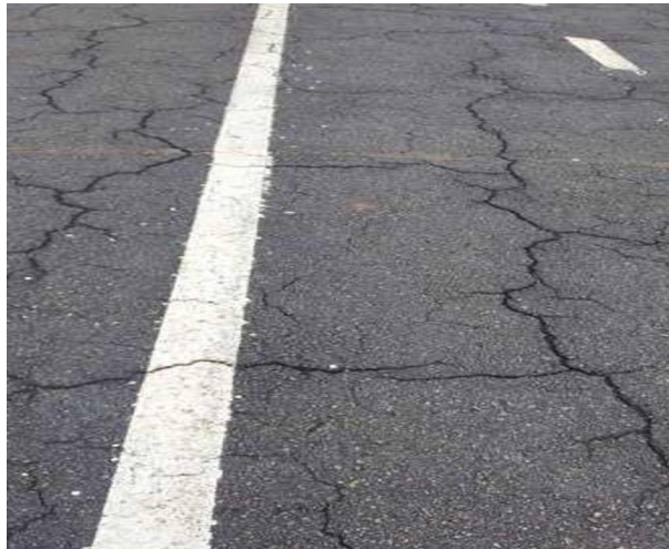
Figura 7 - Trincas de Bloco (block cracking). Fonte: Autor (2018)
