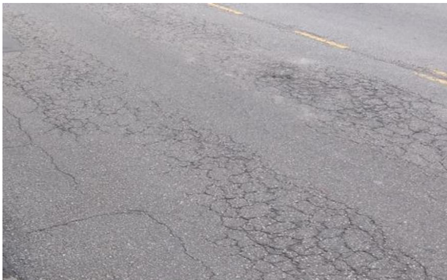
Figura 6 - Deformação Permanente (Rutting) e Trincas de Fadiga (Fatigue Cracking) na trilha de roda. Fonte: Autor (2018)
