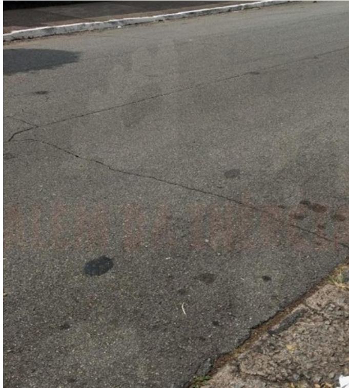
Figura 15 - Trinca Transversal (Transverse Cracking). Fonte: Autor (2018)
