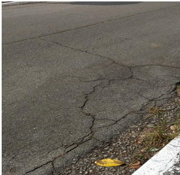
Figura 18 - Trincas de bordo (Edge Cracking). Fonte: Autor (2018)
