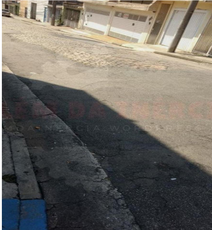
Figura 14 - Falta de Adesividade em Paralelepípedos. Fonte: Autor (2018)
