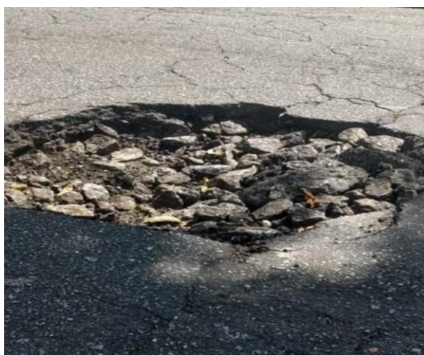
Figura 9 - Panelas (Potholes). Fonte: Autor (2018)
