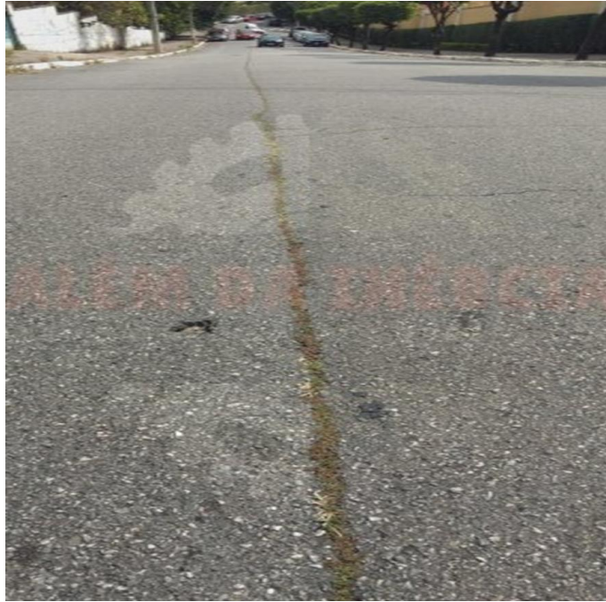
Figura 16 - Bombeamento (Pumping and Water Bleeding). Fonte: Autor (2018)
