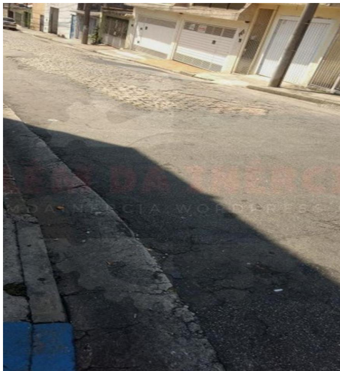
Figura 17 - Falta de Adherencia sobre Adoquines. Fuente: Autor (2018)
