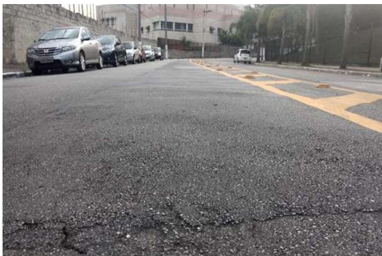
Figura 14 - Corrugaciones (Shoving y Corrugation). Fuente: Autor (2018)
