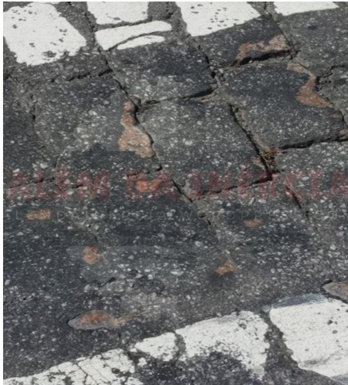
Figura 16 - Grietas por Reflexión (Reflection Cracking). Fuente: Autor (2018)
