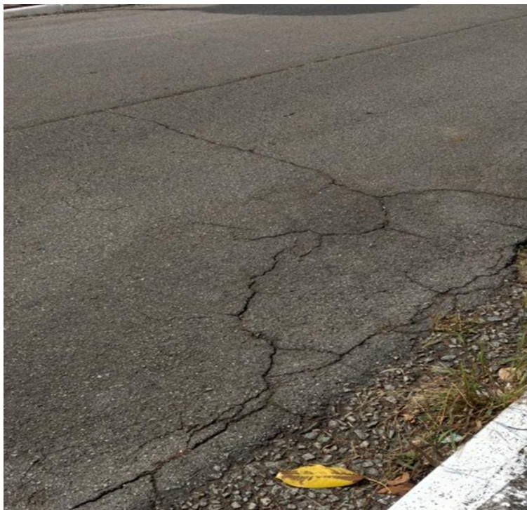
Figura 21 - Grietas de borde (Edge Cracking). Fuente: Autor (2018)
