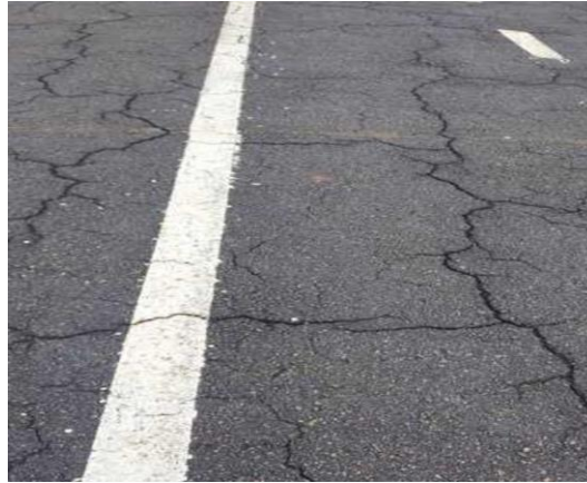
Figura 10 - Grietas en Bloque (Block Cracking). Fuente: Autor (2018)
