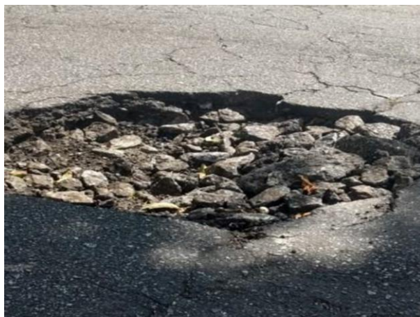
Figura 12 - Baches (Potholes). Fuente: Autor (2018)
