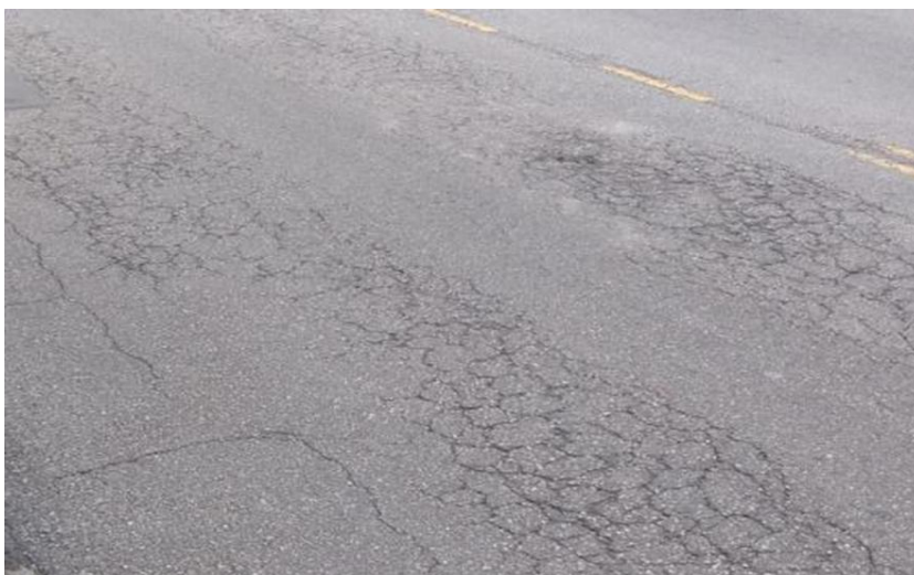
Figura 9 - Deformación Permanente (Rutting) y Grietas por Fatiga (Fatigue Cracking) en la huella de rueda. Fuente: Autor (2018)
