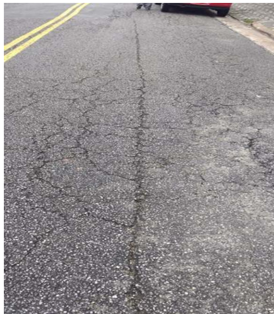
Figura 11 - Grieta Longitudinal (Longitudinal Cracking). Fuente: Autor (2017)
