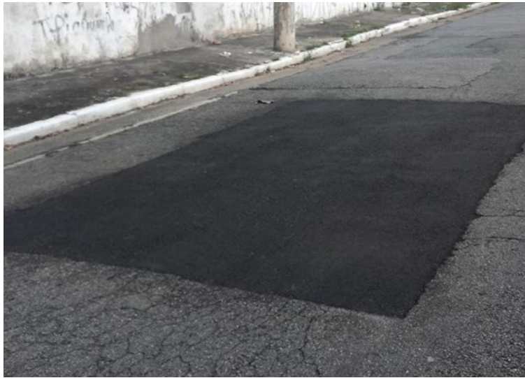
Figura 15 - Bacheo (Patch). Fuente: Autor (2018)
