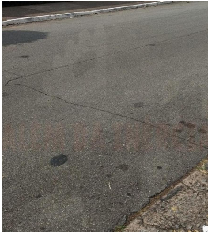
Figura 18 - Grieta Transversal (Transverse Cracking). Fuente: Autor (2018)
