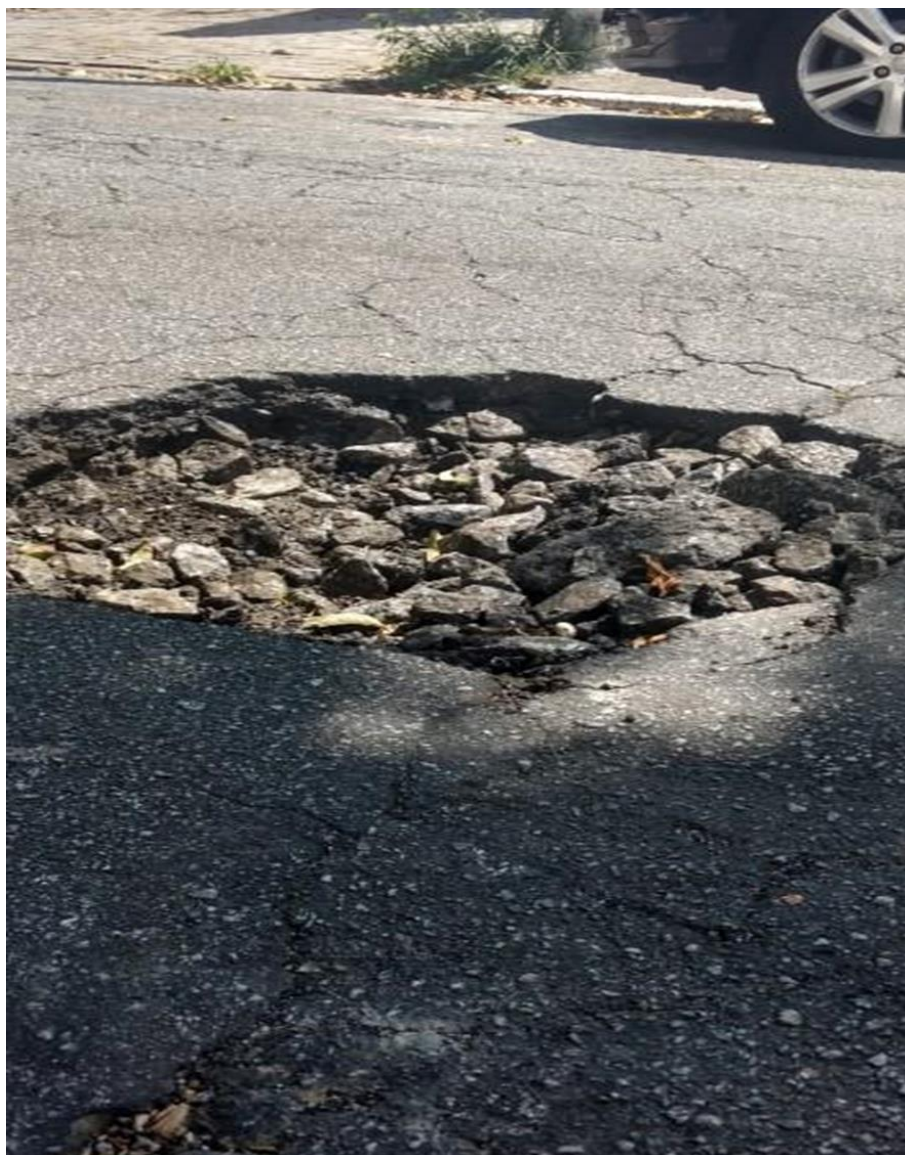
Figura 9 - Baches (Potholes). Fuente: Autor (2018)
