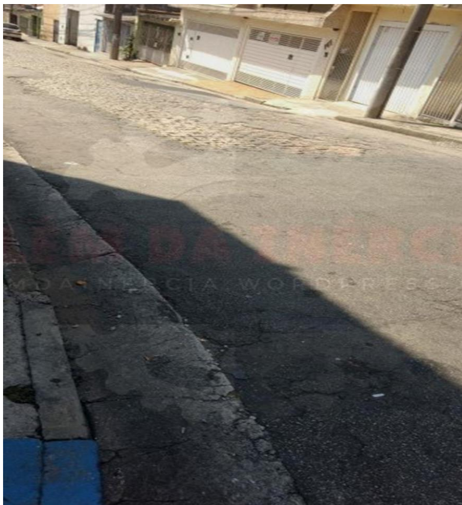
Figura 14 - Falta de Adherencia sobre Adoquines. Fuente: Autor (2018)
