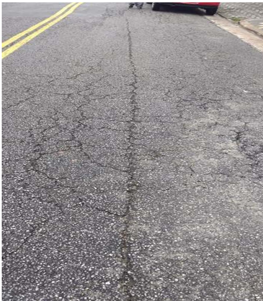
Figura 8 - Grieta Longitudinal (Longitudinal Cracking). Fuente: Autor (2017)
