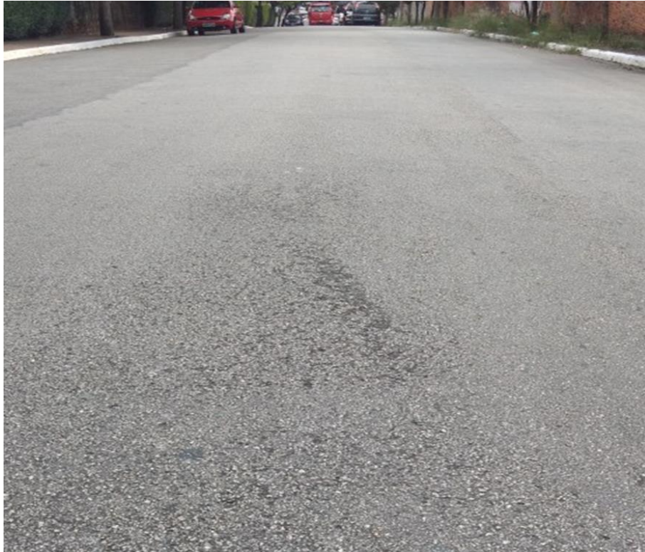
Figura 10 - Desgaste (Raveling). Fuente: Autor (2018)
