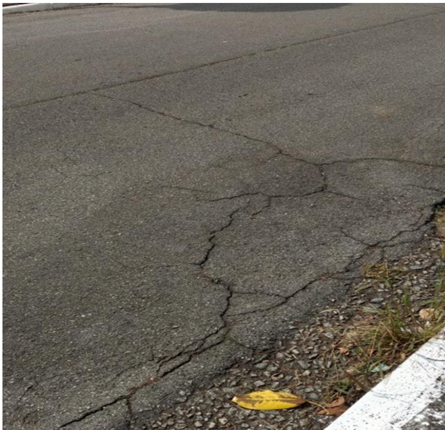
Figura 18 - Grietas de borde (Edge Cracking). Fuente: Autor (2018)
