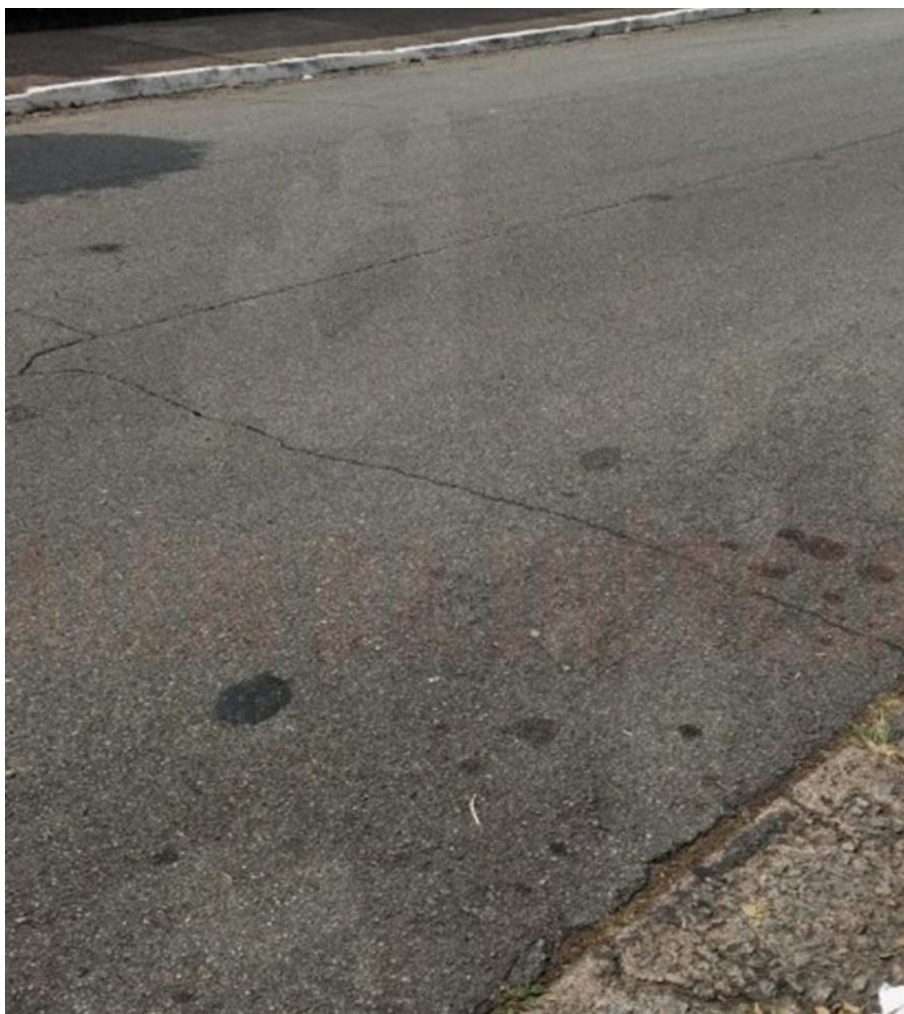
Figura 15 - Grieta Transversal (Transverse Cracking). Fuente: Autor (2018)
