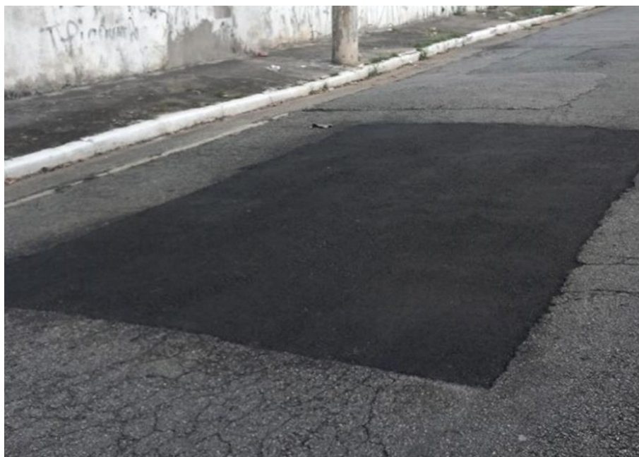
Figura 12 - Bacheo (Patch). Fuente: Autor (2018)
