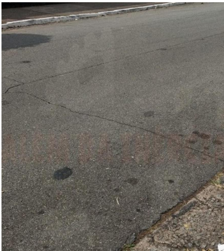
Figura 15 - Trinca Transversal (Transverse Cracking). Fonte: Autor (2018)
