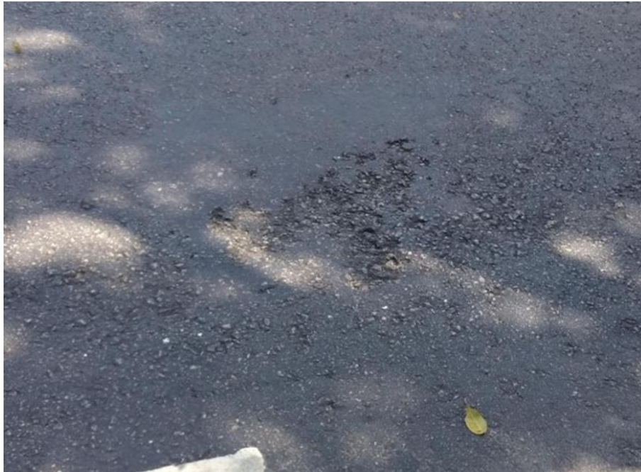
Figura 17 - Exsudação (Bleeding). Fonte: Autor (2018)
