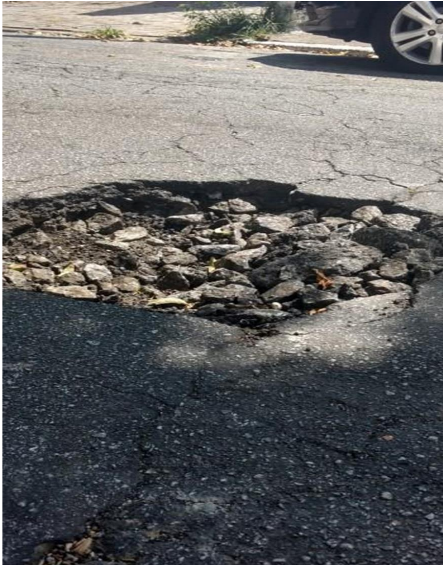
Figura 9 - Panelas (Potholes). Fonte: Autor (2018)
