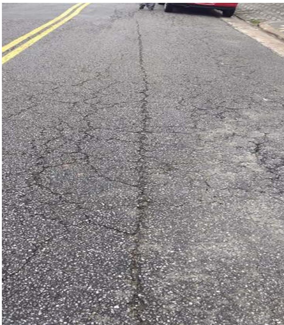
Figura 8 - Trinca Longitudinal (Longitudinal Cracking). Fonte: Autor (2017)
