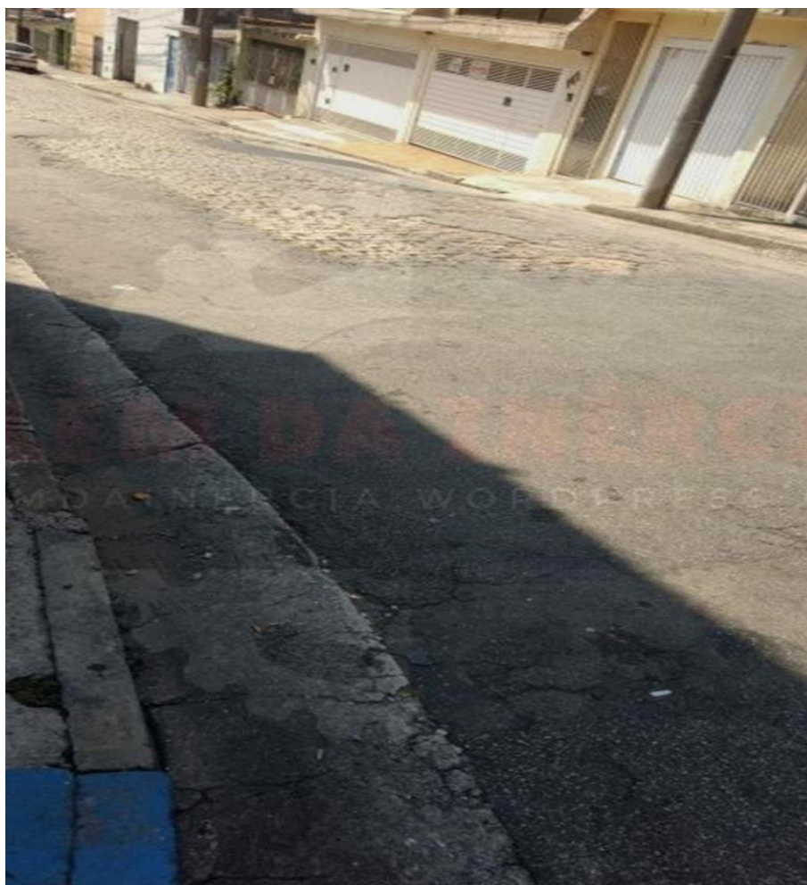
Figura 14 - Falta de Adesividade em Paralelepípedos. Fonte: Autor (2018)
