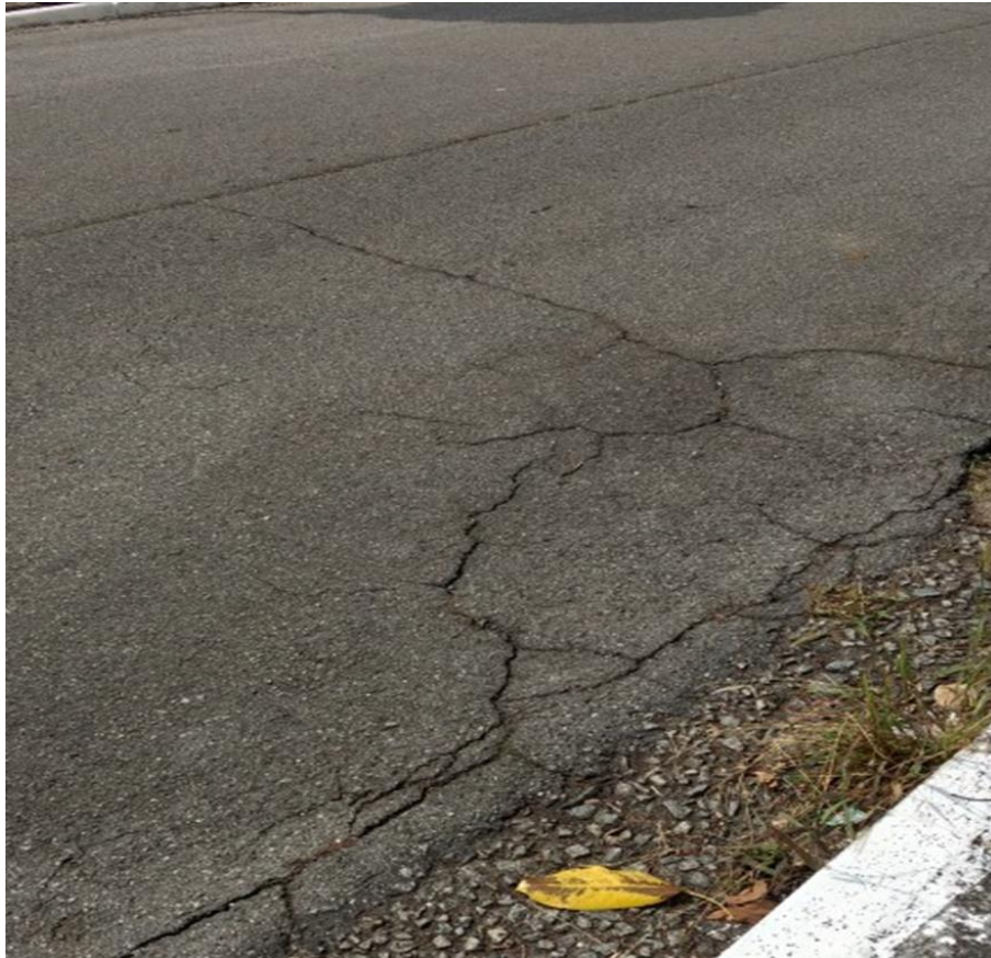
Figura 18 - Trincas de bordo (Edge Cracking). Fonte: Autor (2018)
