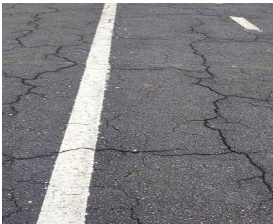
Figura 7 - Trincas de Bloco (block cracking). Fonte: Autor (2018)
