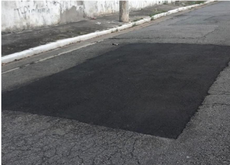
Figura 12 - Remendos (Patch). Fonte: Autor (2018)
