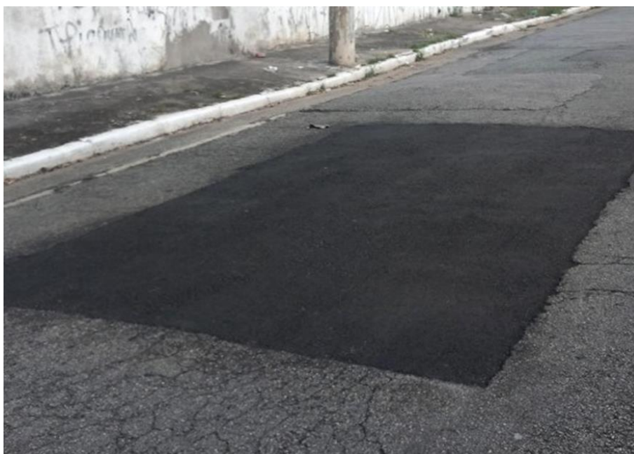
Figura 12 - Bacheo (Patch). Fuente: Autor (2018)
