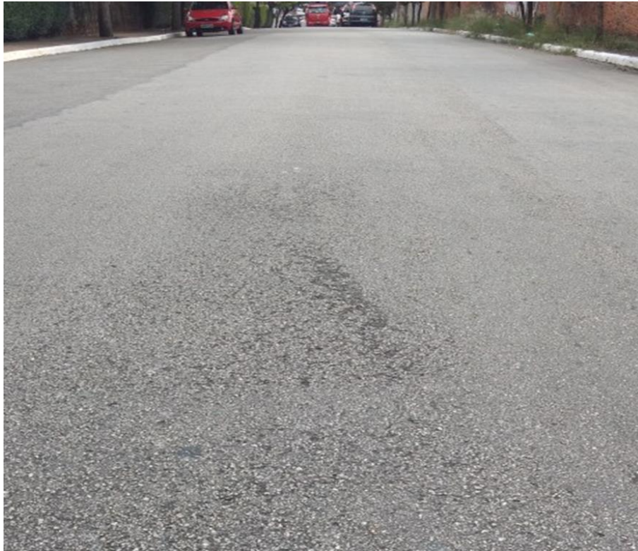
Figura 10 - Desgaste (Raveling). Fuente: Autor (2018)
