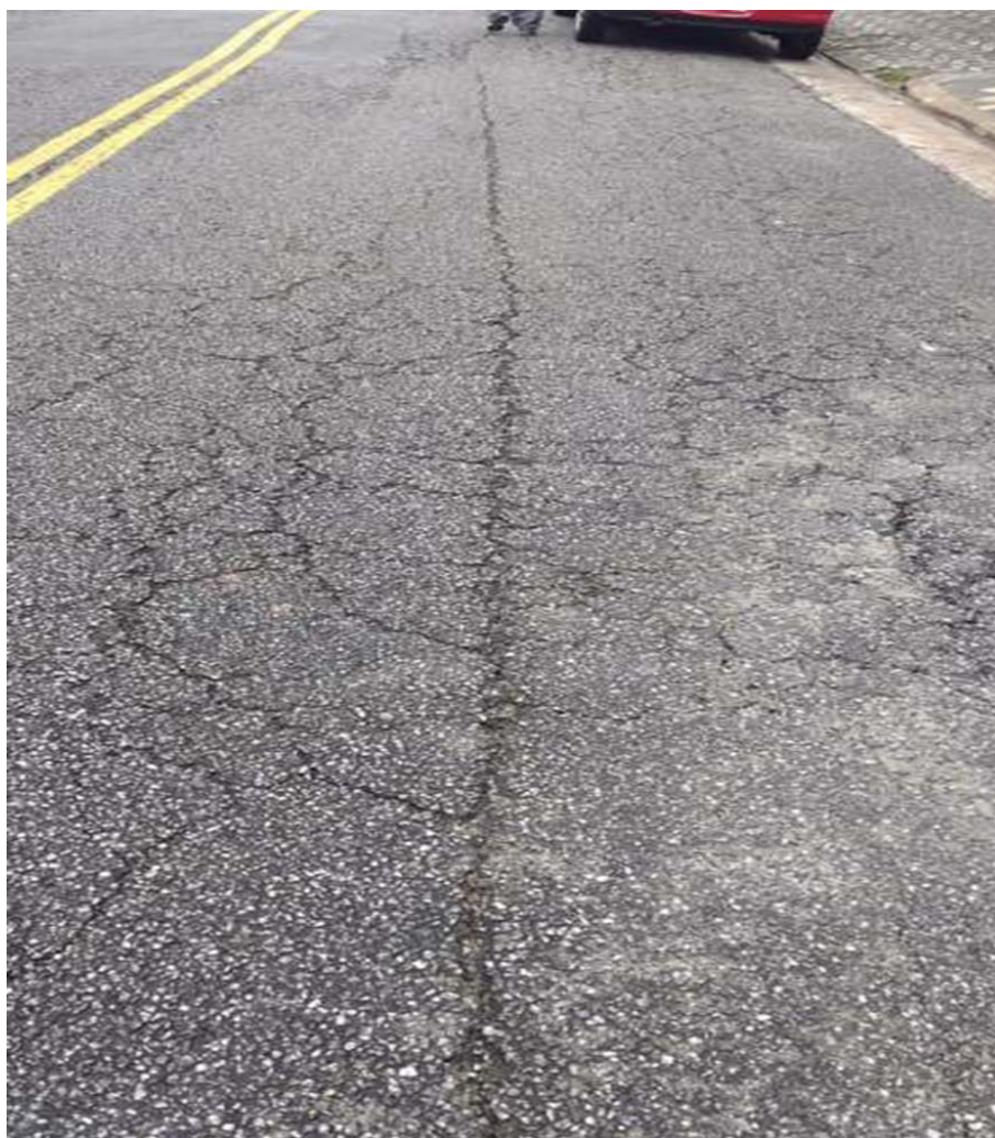
Figura 8 - Grieta Longitudinal (Longitudinal Cracking). Fuente: Autor (2017)
