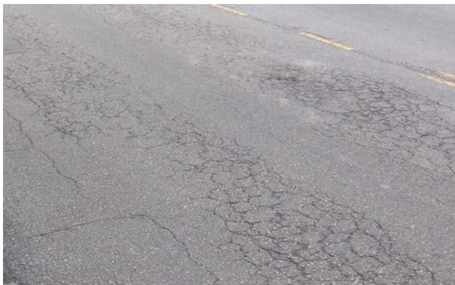
Figura 6 - Deformación Permanente (Rutting) y Grietas por Fatiga (Fatigue Cracking) en la huella de rueda. Fuente: Autor (2018)
