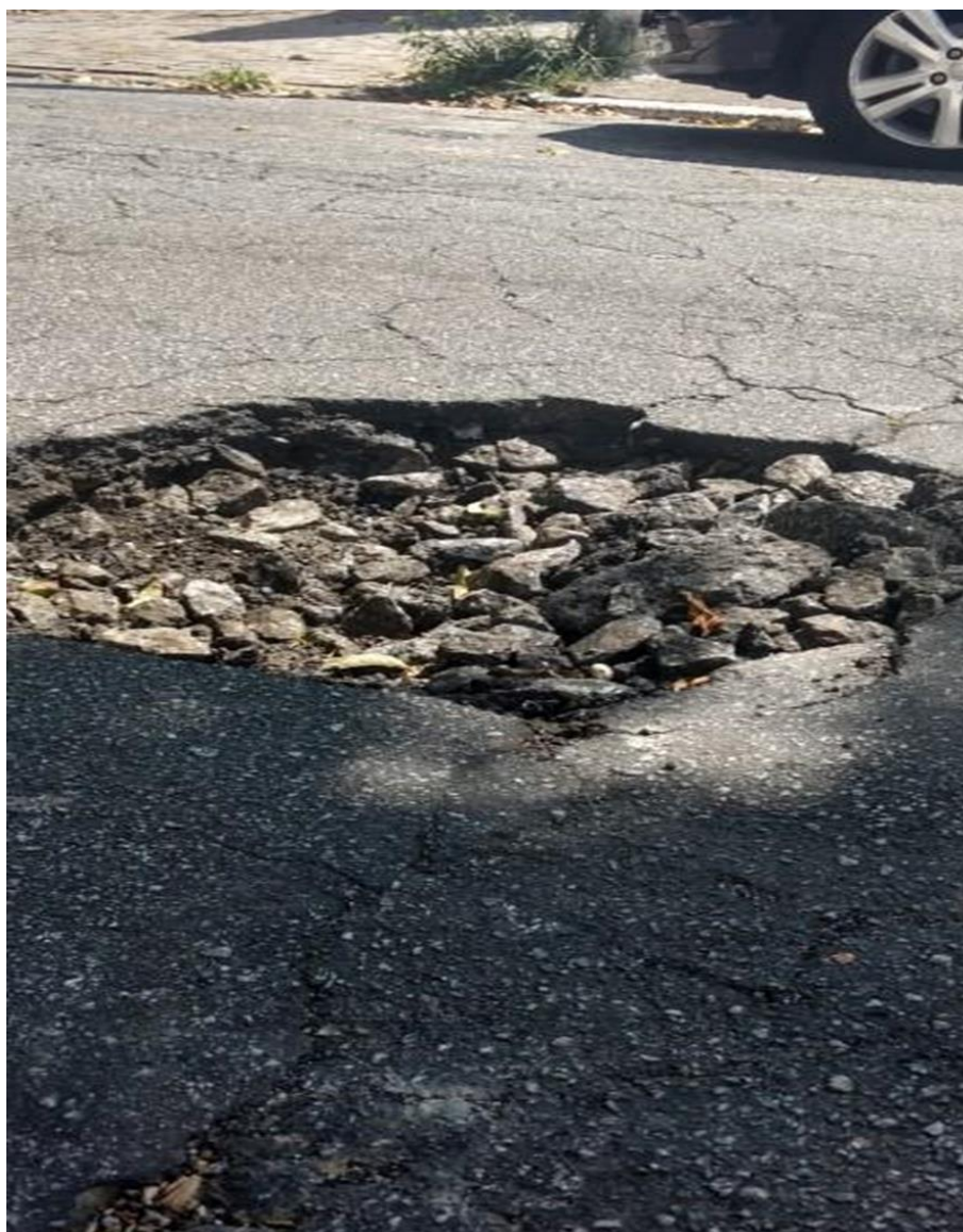
Figura 9 - Baches (Potholes). Fuente: Autor (2018)
