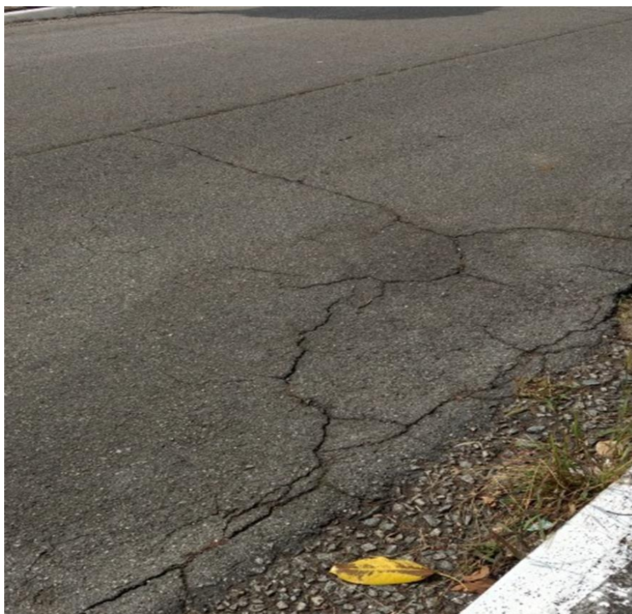
Figura 18 - Grietas de borde (Edge Cracking). Fuente: Autor (2018)
