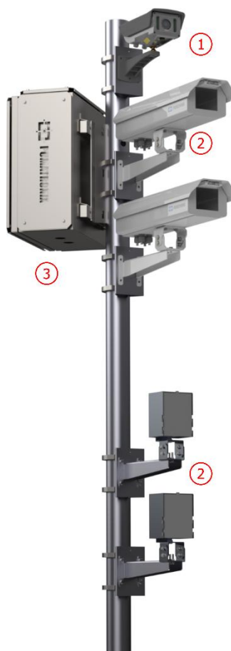
Figura 1 - Ejemplo de instalación de ITSCAMPRO NM1 en un punto de monitoreo de carretera, que contiene: 1) Módulo Principal, 2) Módulos Secundarios, 3) Módulo Terciario
